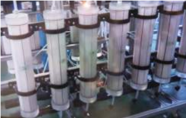
ROの前処理工程で使用されている例
